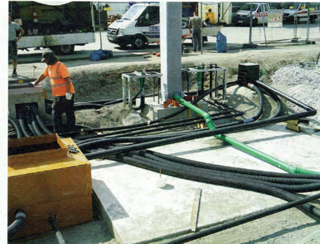
Im Serviceangebot von Geisler sind auch Automattentankstellen. Hier wird eine solche Anlage in Brilon neu errichtet.
